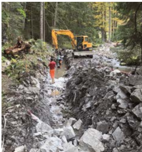
Les nouvelles conduites pour la traversée de la Salanfe ont été installées cet automne.
